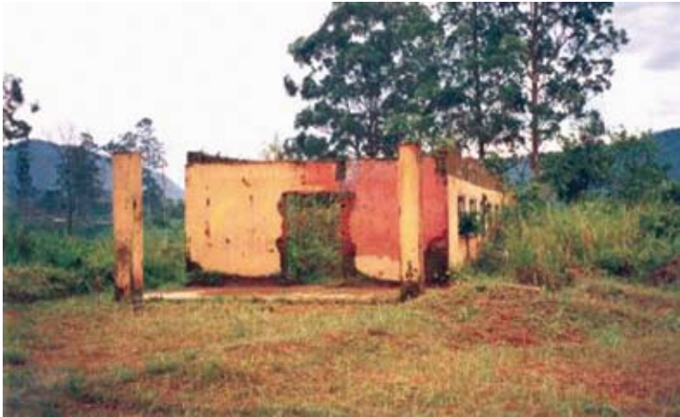
Edificio del Centro sanitario di Kibati dopo il bombardamento del Luglio 1999 (Foto archivio Maendeleo-Italia)
